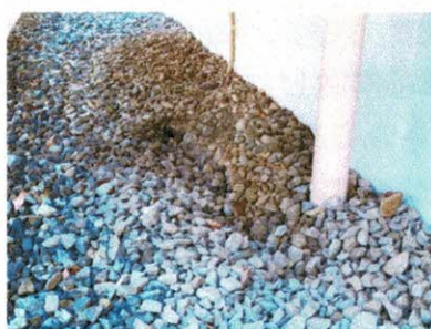
3号棟北側陥没
