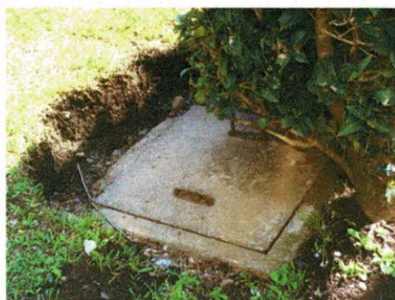
4号棟東南 雨水桝陥没
