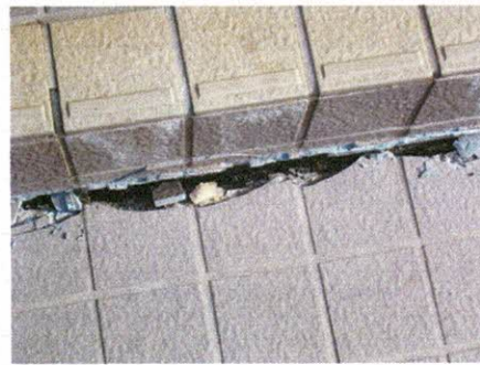
7号棟第3階段 目地剥がれ
