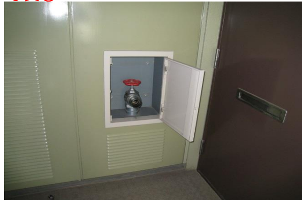
連結送水管放水口（3～8階メーターボックス内）
