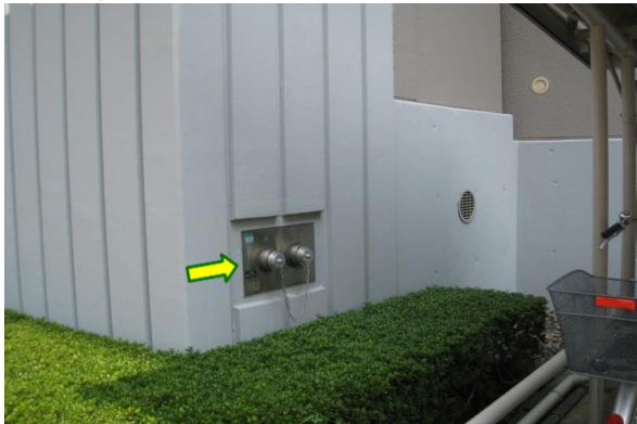
連結送水管注水口（第2階段地上階土台部）
