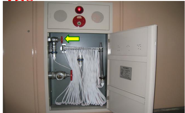
消火栓 (メーターボックスにはめ込まれている。普段は扉が閉じられています。扉の左端を強めに引くと開きます。)
