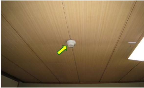
火災感知器 (各居室の天井中央付近に設置)
