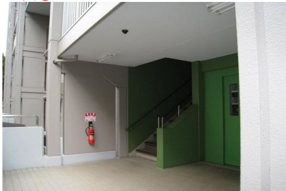
4号棟（エレベーター停止階）
