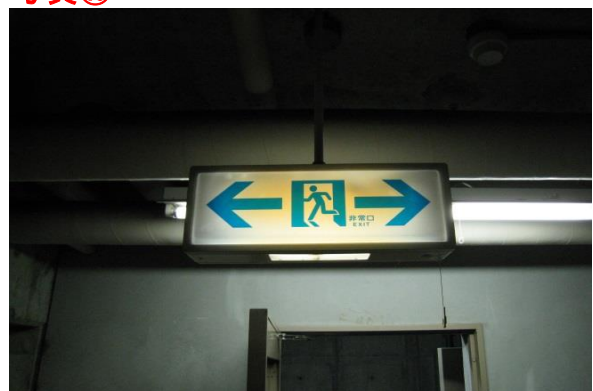
誘導灯（地下駐輪場の例）
