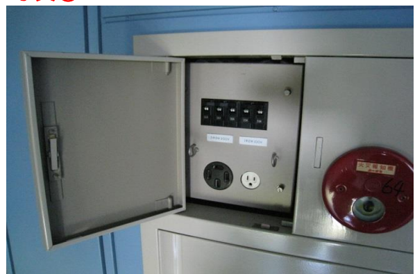
非常電源コンセント
