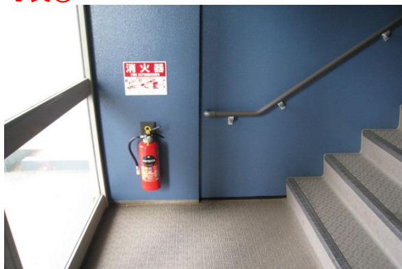
6・7号棟（エレベーター付き階段室の全階に設置、エレベーターなし階段室には一切なし。）
