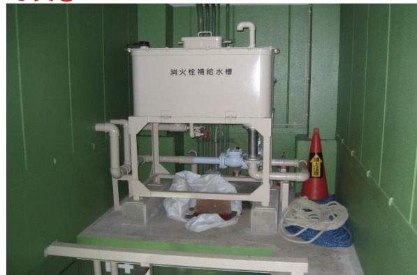
消火栓補給水槽（水位が下がると水道水が自動的に補給される構造）
