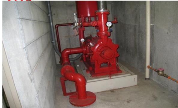
消火栓ポンプ (6号棟地下)
