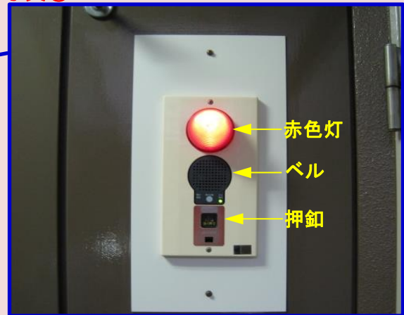
火災報知設備(各階段室1階メーターボックス)
