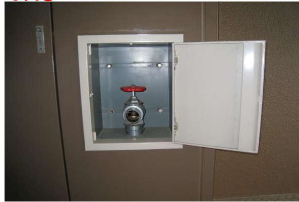
連結送水管放水口（3～8階エレベーターホール壁面の専用扉を開けてホースをつなぐ。）
