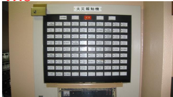
自動火災報知表示盤
