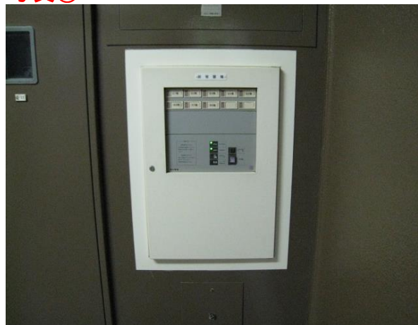
5号棟専用の警報表示盤（階数表示ランプが点灯し、警報ボタンが押された位置を表示する。）
