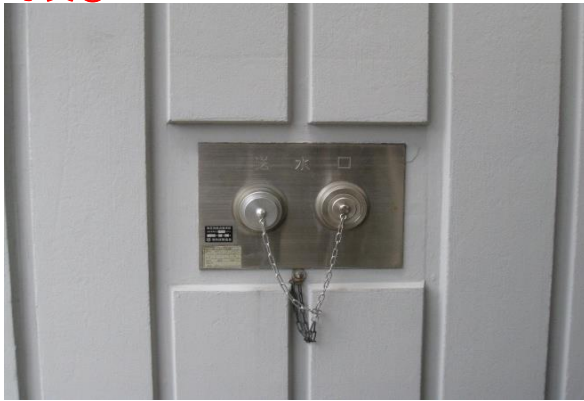
連結送水管注水口（地上から1階への階段裏側外壁に設置されている。）
