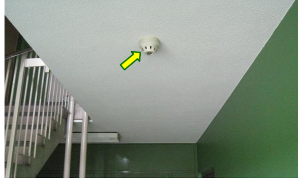
煙感知器 (各階段室の5・10・14階に設置)
