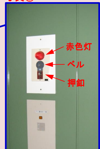
火災報知設備(1・4・6階メーターボックス前面)
