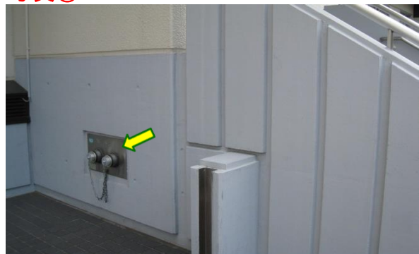
連結送水管注水口 (6号棟は第4階段室、7号棟は第2階段室の地上階土台部にある。)
