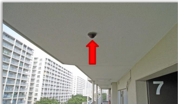
写真5 防犯警報表赤色灯(5号棟)
