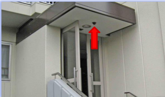
写真7 防犯警報表赤色灯(6・7号棟)
