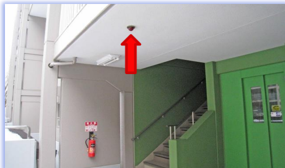
写真4 防犯警報表赤色灯(4号棟)
