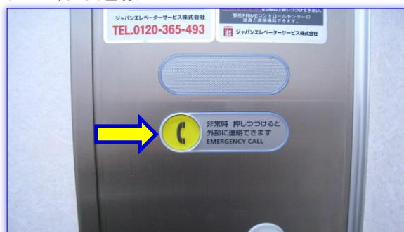
図4 非常通報ボタン
