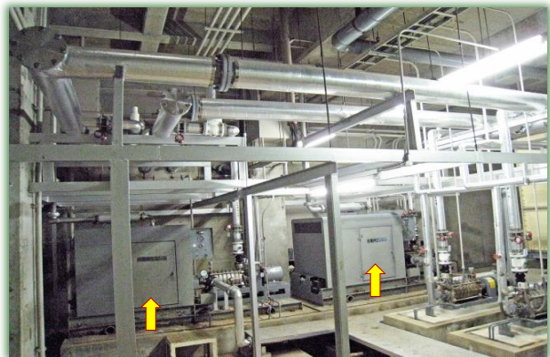
図4 給水プラント非常用エンジン(矢印の2台)
