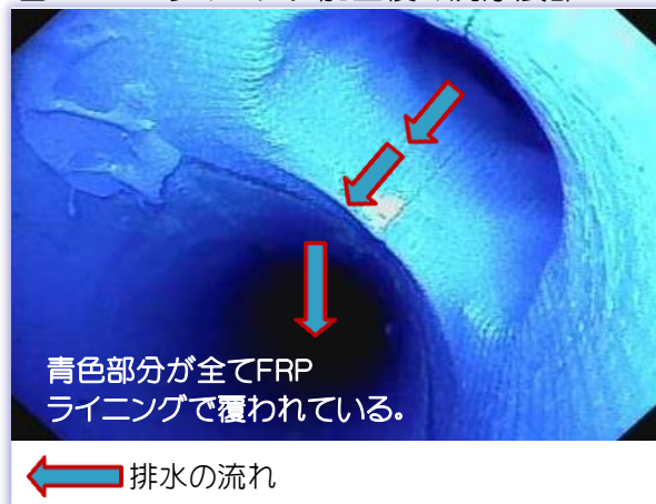
図2 FRPライニング加工後の洗浄痕部
