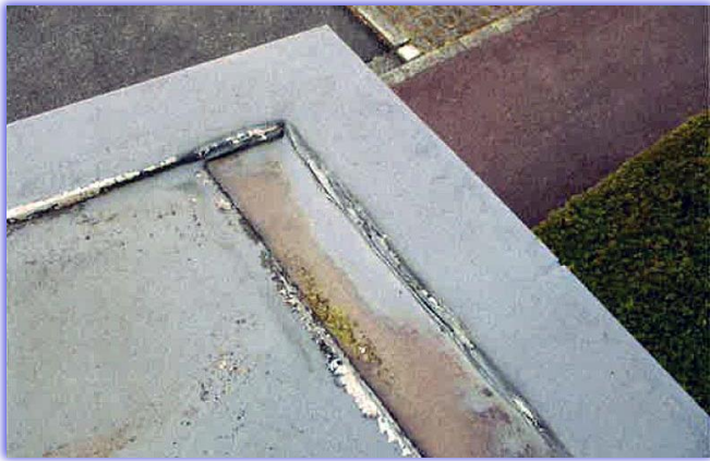
図3 低層棟1階エントランス庇の屋根(塗装劣化)
