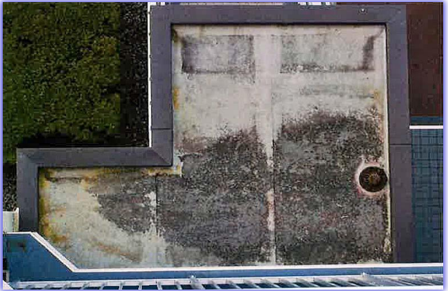
図4 高層棟エントランス庇の屋根(防水シート劣化)
